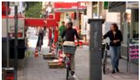
Nur 200 Meter davon entfernt: Ungesicherte Baustelle auf der Venloer Straße
